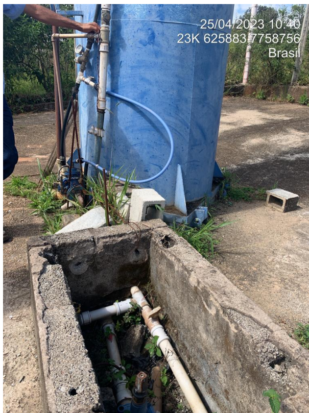
CAIXAS DE MANOBRA
