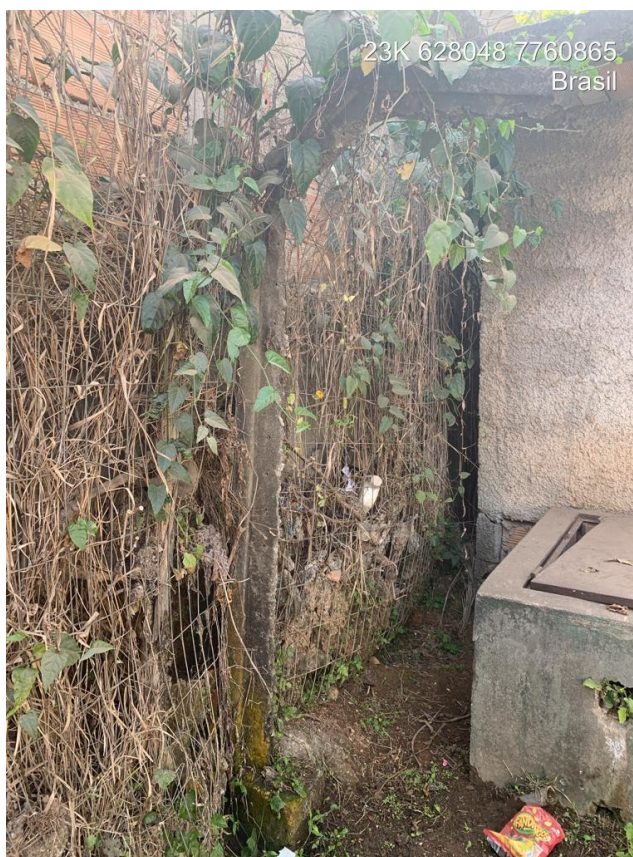
NECESSIDADE DE LIMPEZA E CONTENÇÃO DA DIVISA
