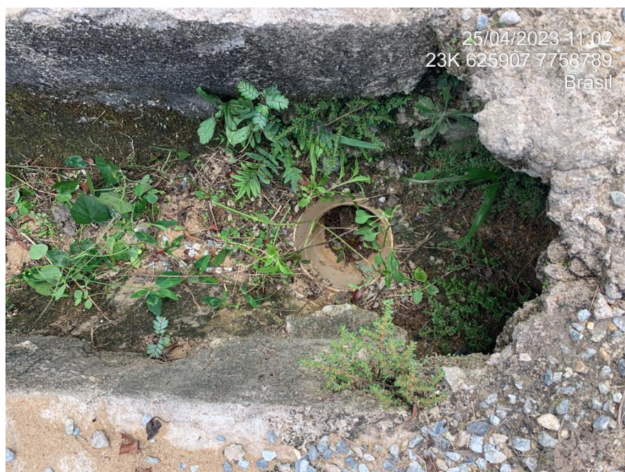
CANALETA E CAPTAÇÃO DE ÁGUAS PLUVIAIS PRÓXIMO AO PORTÃO
