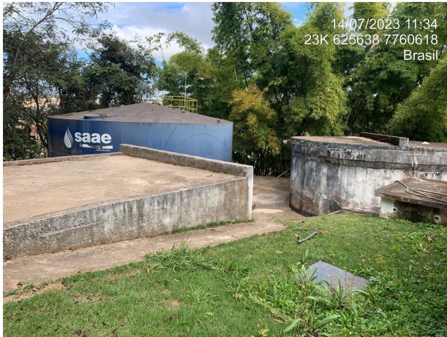
FALTA DE GUARDA CORPO
